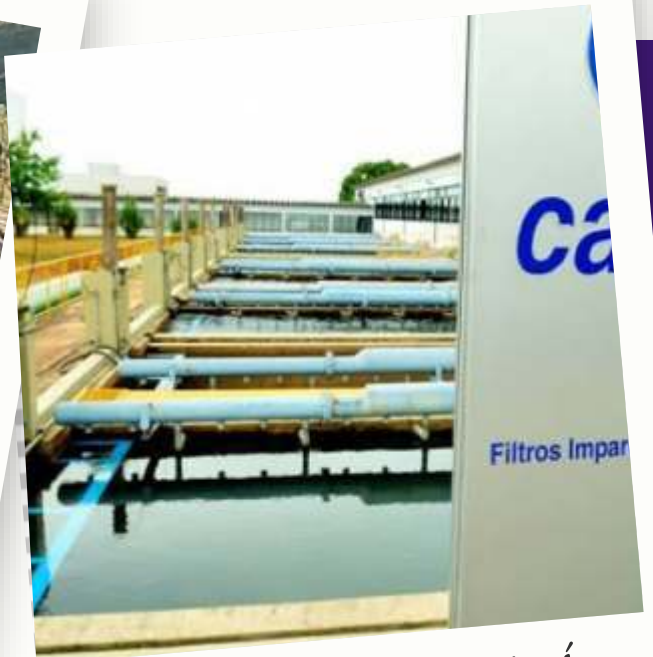
Estação de Tratamento de Água
